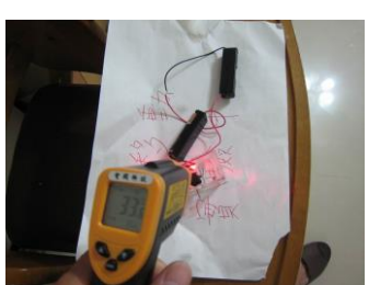
(20) 電線連接處 33.6 度
