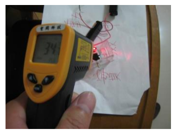
(17) 電線連接處 34.7 度
